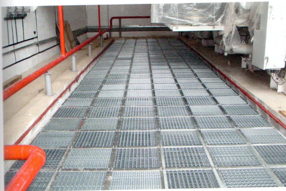
▲ Пример размещения устройств самотушения проливов ГЖ и ЛВЖ на одном из объектов ТЭК
