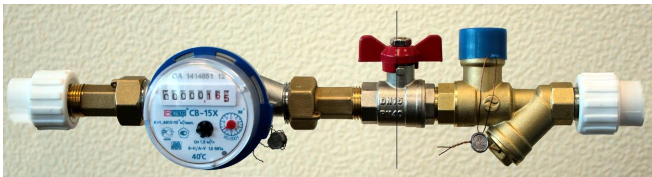
Рис.4 Вид системы ХВС с установленным УВО-01Ф-2Х/15.
